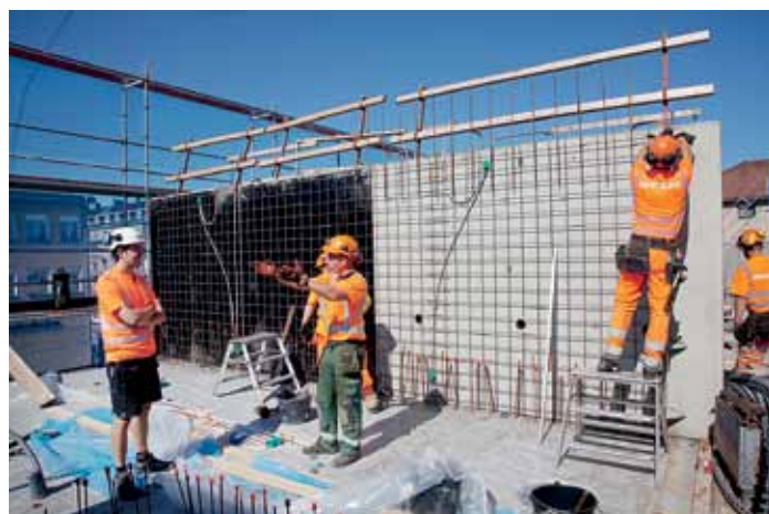
89 nya studentbostäder byggs mitt i centrala Örebro. Lägenheterna ska vara klara till höstterminen 2014.
