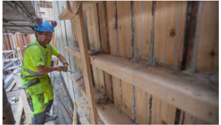
Stora dammluckor av ek ska reglera vattentillförseln genom dammen. Här är Jan-Åke Graans på plats vid bygget.
