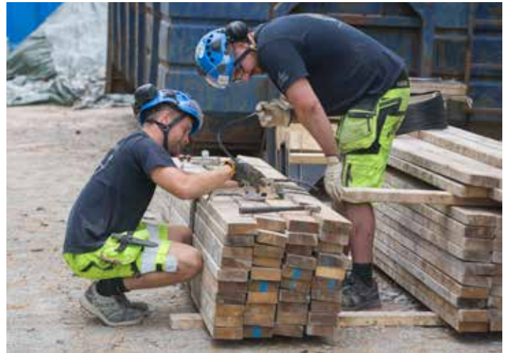
Tungdykarna Andreas Bengtsson och Josef Eider har gjort sitt jobb under ytan vid dammbygget. Nu hjälper det till med formbyggnation.
