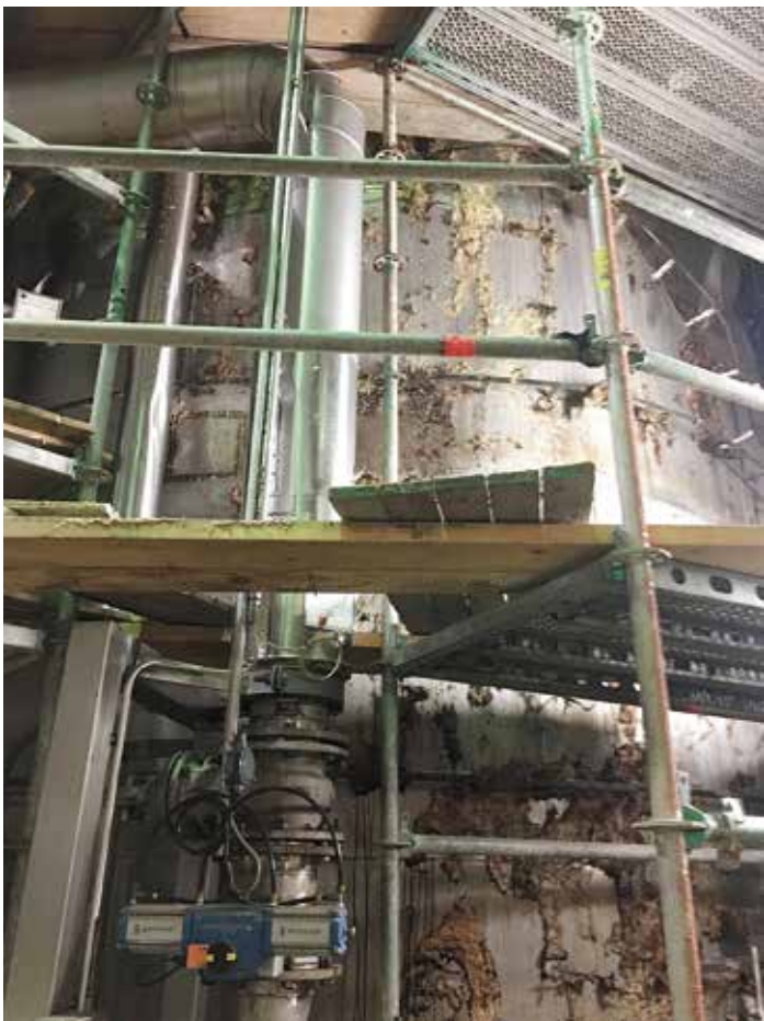
Ställningsbygge på Billerud Korsnäs i Grums som var märkt med beträdningsförbud när Byggnads kom på besök. Men dagen innan hade den en grön godkänd-skylt. Foto: Byggnads
