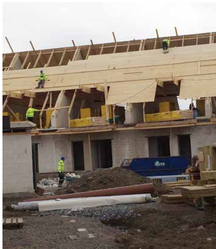
Arbetsmiljöverket har utfärdat ett omedelbart förbud för Villa Z:s byggprojekt på Stenvägen i Mosås utanför Örebro. Byggnadsarbetarna arbetar på taket utan några som helst skyddsanordningar. Om inte fallskydd monteras riskerar företaget att få böter på 50 000 kronor. Foto: Byggnads
