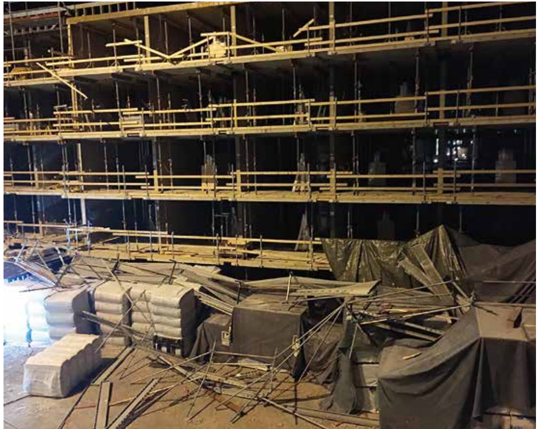
Säkerheten är inte mycket värd när byggställningen blåser ner. Här har ställningsföretaget No problems återigen bevisat att de slarvar med säkerheten. Foto: Byggnads
