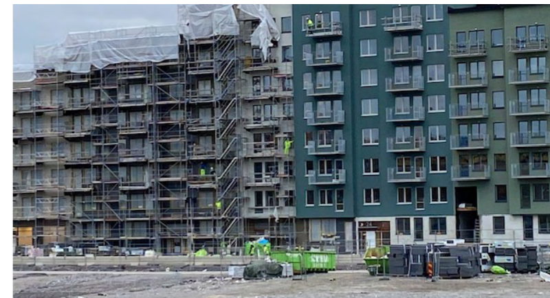
Två byggprojekt i Ursvik, Sundbyberg, blev Årets sämsta bygge 2023. Livsfarliga fallrisker var en av orsakerna.
