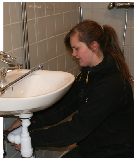
Paulina håller på att färdigställa ett omklädningsrum för personalen i en affärslokal i Plushuset i centrala Avesta.
